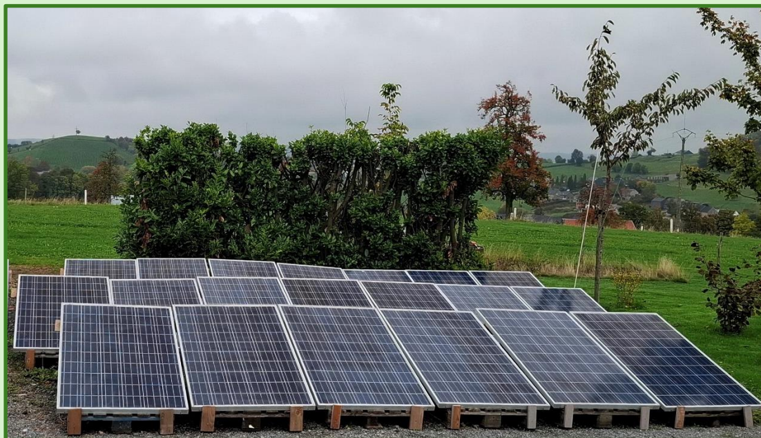
Installation expérimentale de panneaux solaires sur le site de CODEART à Hombourg, permettant de réaliser différentes mesures et de tester divers onduleurs et batteries.
